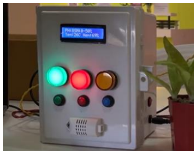
ภาพ 5 กล่องควบคุมอุปกรณ์
